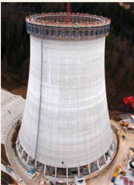
Der Neubau des 164,5 m hohen Kühlturms ist ein Hauptbestandteil der neuen Infrastruktur im Braunkohlekraftwerk Šoštanj. Pro Tag wuchs der Turm um 1,5 Meter.
