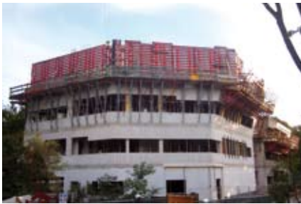
Auf den abgeschrägten Stirnseiten des Laborgebäudes steht die Meva-Wandschalung Mammuthaus auf der Arbeitsbühne LAB 190.
