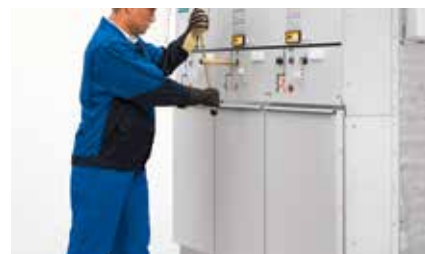
Mittelspannungsschaltanlage als Ortsnetzstation mit regelbaren Transformatoren und Automatisierungskomponenten.
