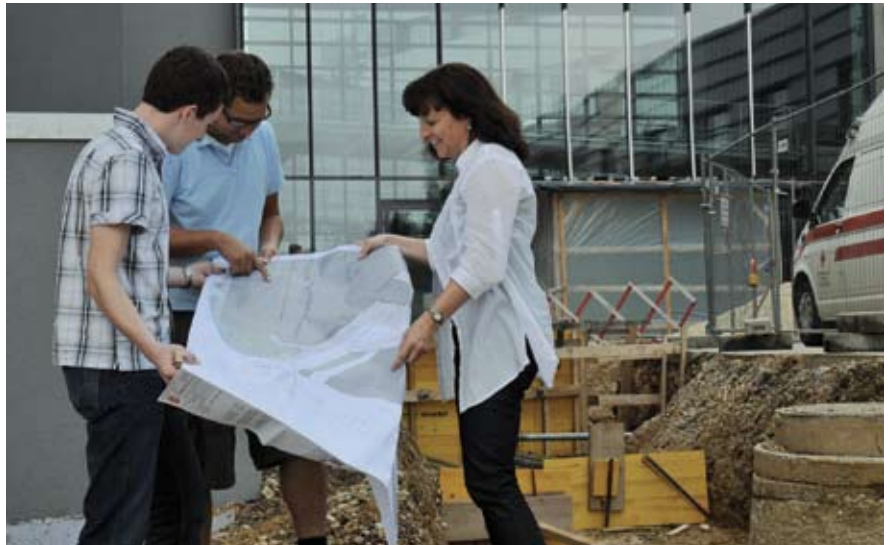
Bei Delta schätzt man die Impulse, die Frauen wie Planerin Heike Leonhardt auf der Baustelle einbringen: Sie haben etwa ein besonderes Gespür für die Förderung der Team-Atmosphäre.
