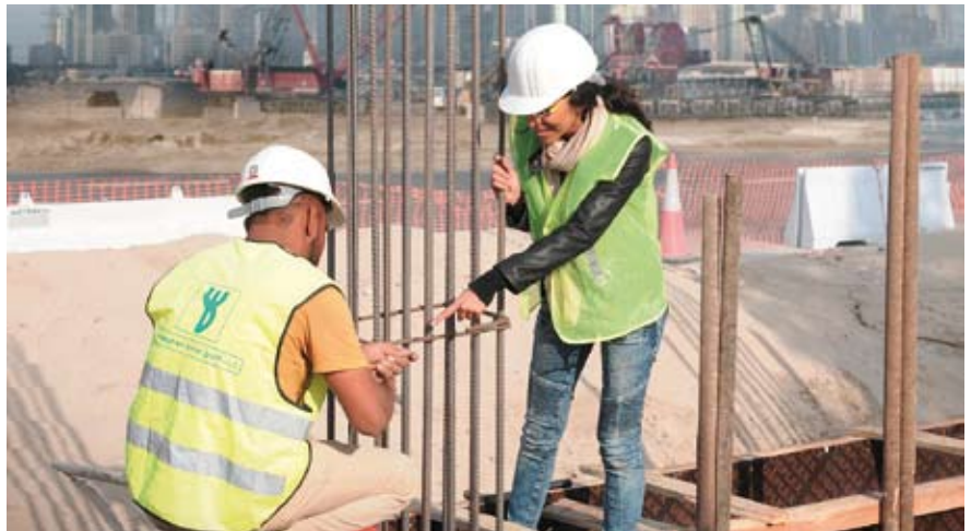
Diversity ist am Bau erfolgsentscheidend. Ein Team mit unterschiedlichen Zugängen erreicht laut Waagner-Biro immer die besseren Lösungen (im Bild: Lilyan Tannous, leitende Ingenieurin bei Waagner-Biro Gulf auf der Baustelle in Dubai).
