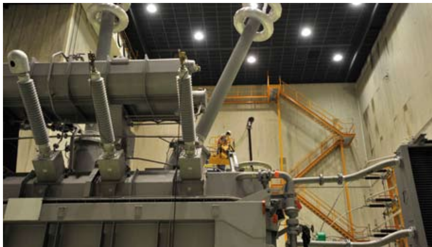
Alstom verfügt mit seinem Werk in Mönchengladbach über Kapazitäten für den Bau von bis zu 140 Transformatoren jährlich.
