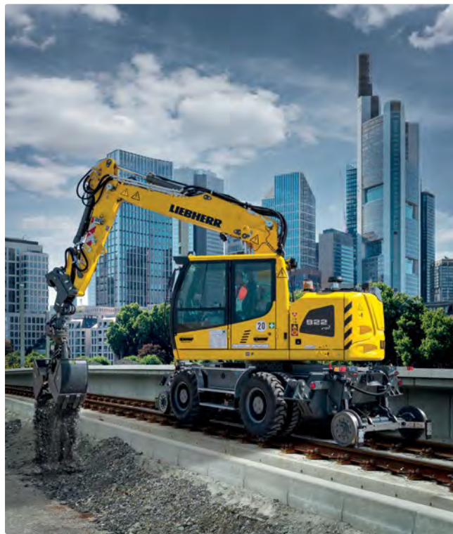
Die ECM-Zertifizierung ist für Fahrzeughalter von Zweiwegebaggern verpflichtend.
