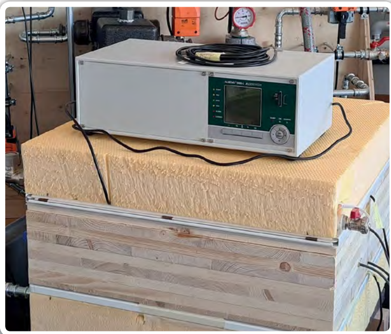
Bauteilaktivierung mit Massivholz steht im Gegensatz zu jener mit Beton noch in den Startlöchern. Erste Forschungen laufen an der FH Salzburg, abgeschlossen ist das Projekt aHolz – Aktiviertes Brettsperrholz, als Folgeprojekt läuft Activation.Wood.
