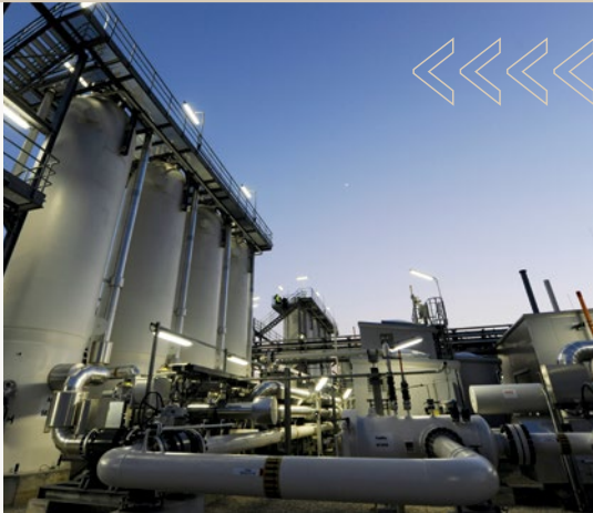
Anschluss gewünscht: Der Speicher Haidach soll mit dem österreichischen Leitungsnetz verbunden werden.
