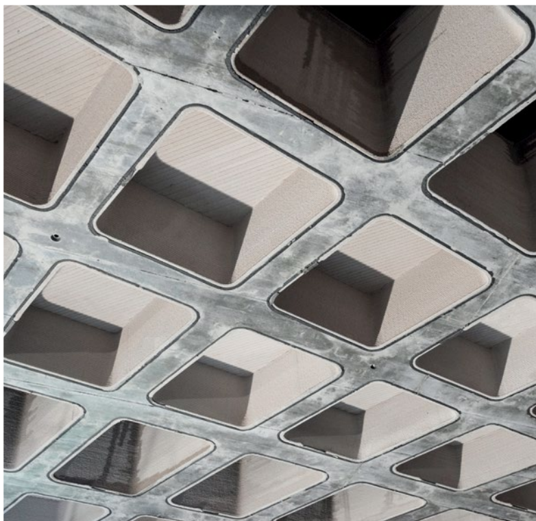
Die additive Fertigung für die Herstellung von Schalungen ist eine innovative und vielversprechende Methode im konventionellen Stahlbetonbau. (Projekt Atelierdecke Schloss Seehof, ITE TU Graz mit Baunit, Schloss Seehof in Lunz am See)
