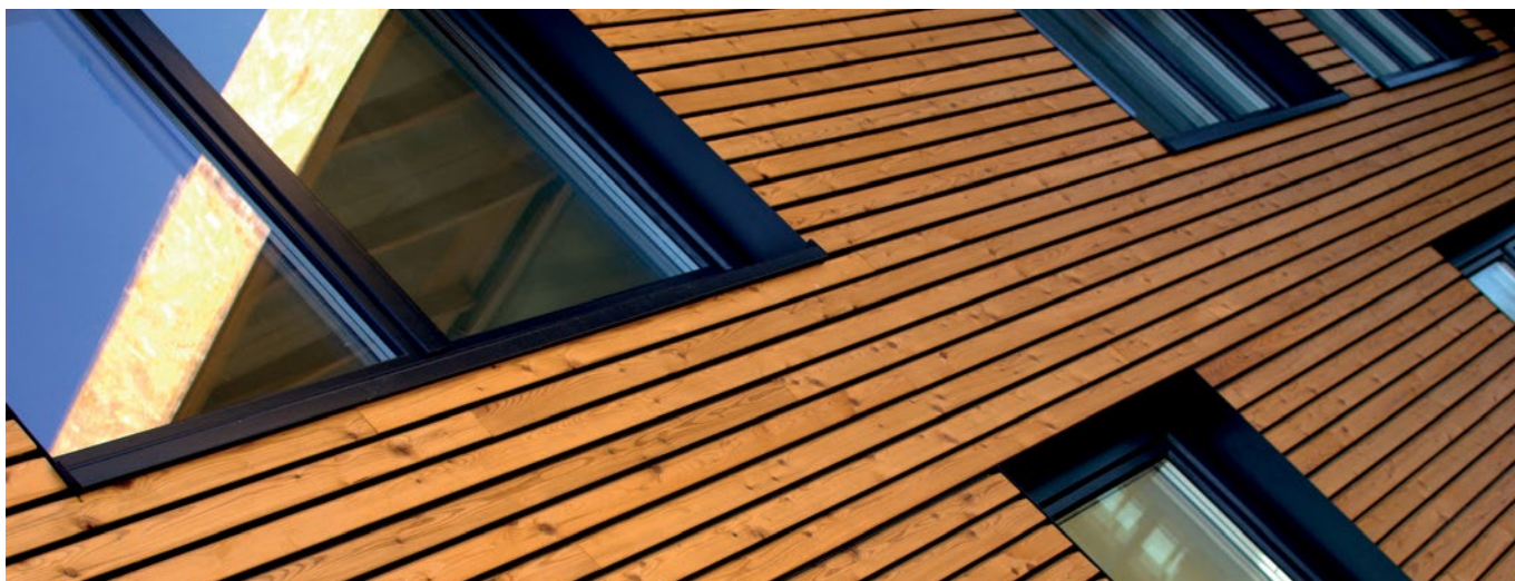
Holzfassaden werden stark nachgefragt, die größte Fehlerquelle liegt in der Verarbeitung. An besseren Profilen und Oberflächen wird geforscht.
