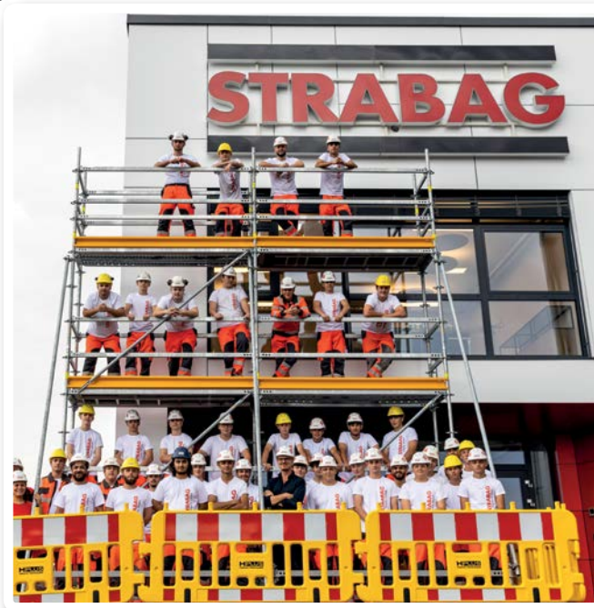
Bei der Errichtung des neuen Lehrlingsquartiers durften die Strabag-Lehrlinge auch selbst Hand anlegen und das Wärmedämmverbundsystem anbringen.
