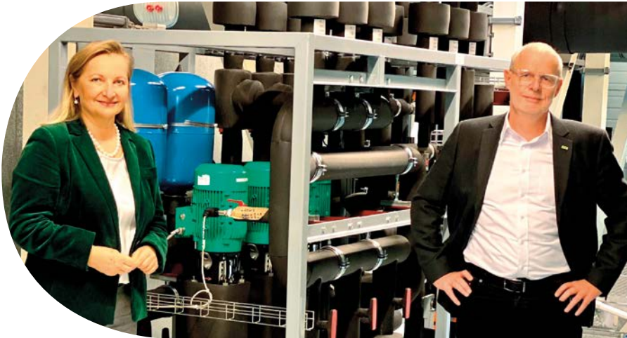
Ulrike Rabmer-Koller, Rabmer Gruppe, und Wolfgang Timelthaler, E+E Elektronik, konnten mit dem innovativen Wärme- und Kälterückgewinnungssystem ein wichtiges Umweltprojekt abschließen.
