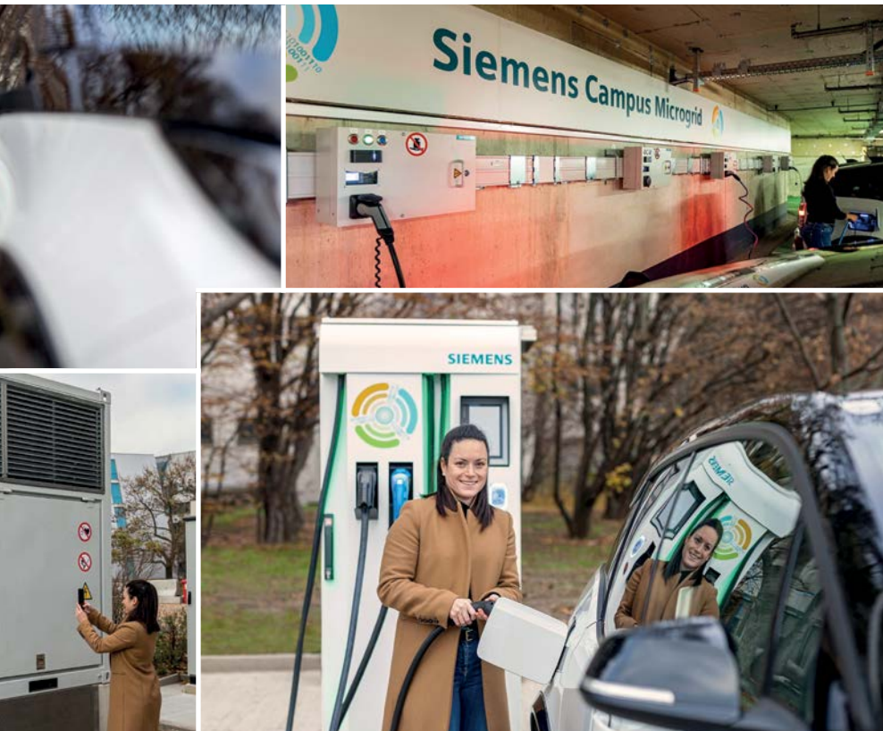
Stromspeicher und unterschiedliche Ladelösungen am Siemens-Gelände.
