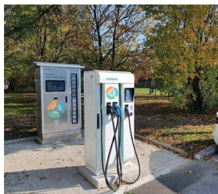
»Compact Power Charger« und der zentrale Controller des Microgrid.
