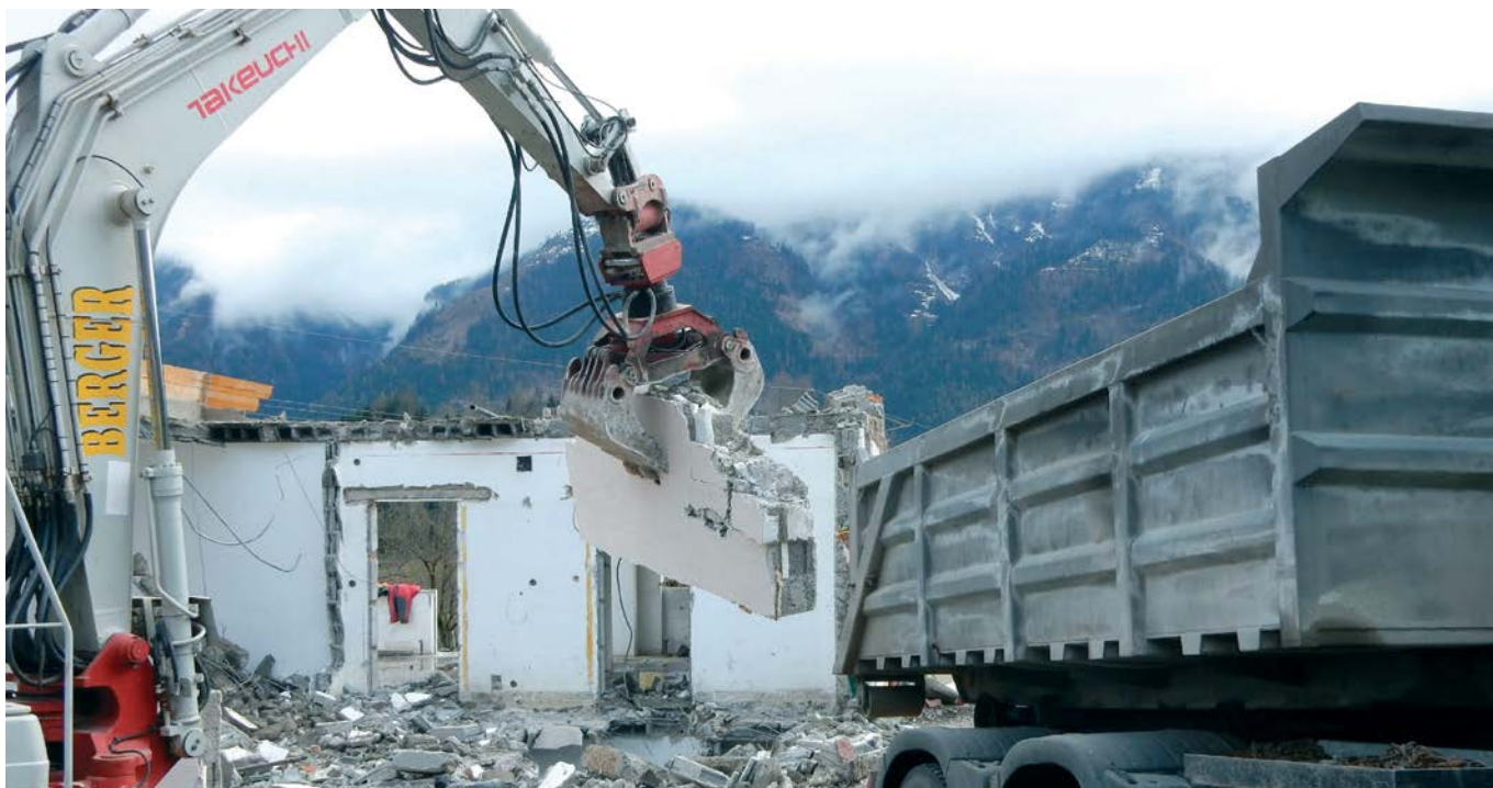
Immer öfter wird Betonrecycling-Material als Substitutionsprodukt für den primären Rohstoff Kies eingesetzt, denn zunehmend bestehen Probleme, ausreichend für die Betonproduktion geeigneten Kies und Sand abbauen zu können.
