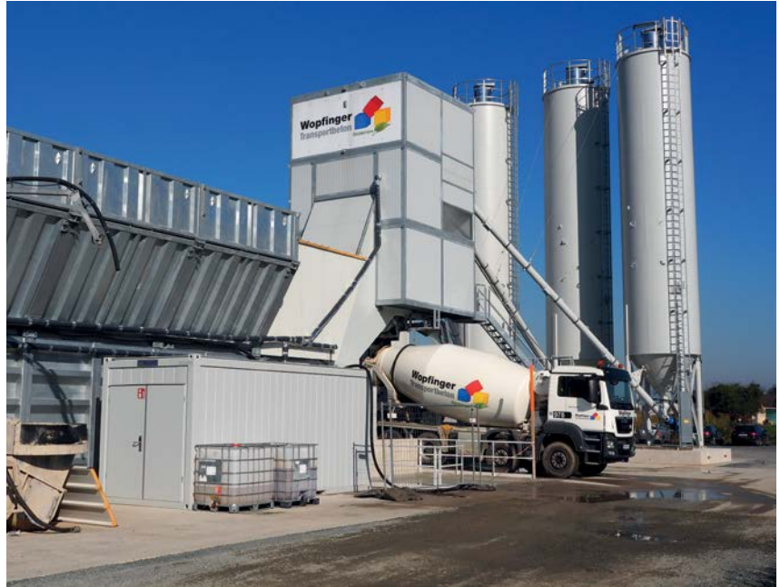
Beton vor Ort auf der Baustelle situationsbezogen herzustellen, spart wesentlich an Zeit und Kosten. Wopfinger Transportbeton setzt auf mobile Mischanlagen bei Infrastrukturprojekten wie der S7 Fürstenfelder Schnellstraße oder dem Koralmtunnel.
