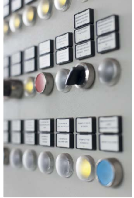
STEUERANLAGE. Steuerung eines Holzheizkraftwerks. Die Imagefotos wurden von Next Kraftwerke bereitgestellt.
