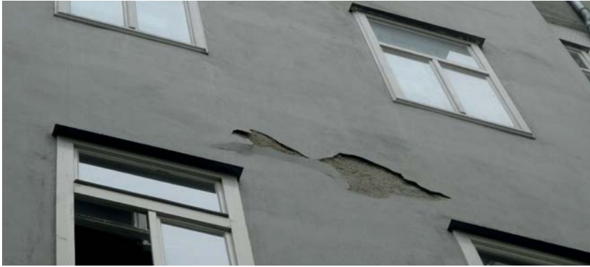
Einer der häufigsten Mängel im mehrgeschoßigen Wohnbau trifft den Bereich Fassaden, speziell bei Hauptgesimsen.
