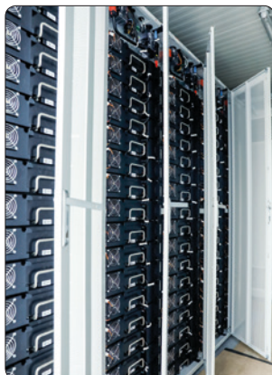
Lokale Pufferbatterie am Standort Mellach für Batterietests.
