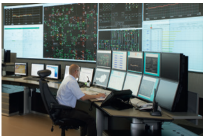
Strom-Zentrum Österreichs: die Steuerzentrale der APG.
