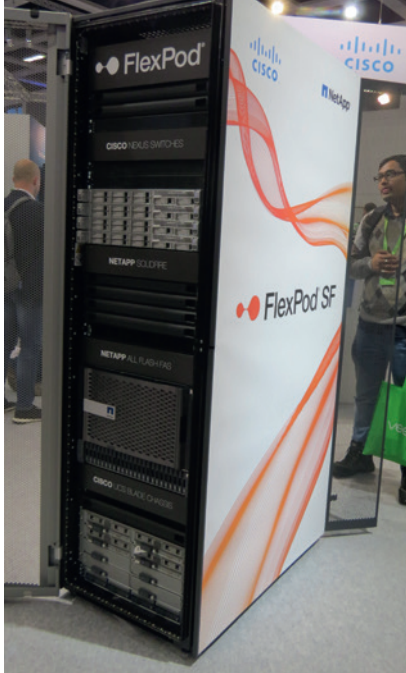
Live auf der Insight-Expo zu besichtigen war FlexPod, erstellt mit NetApp SolidFire Element OS, Cisco Unified Computing System und Cisco Nexus Switching.
