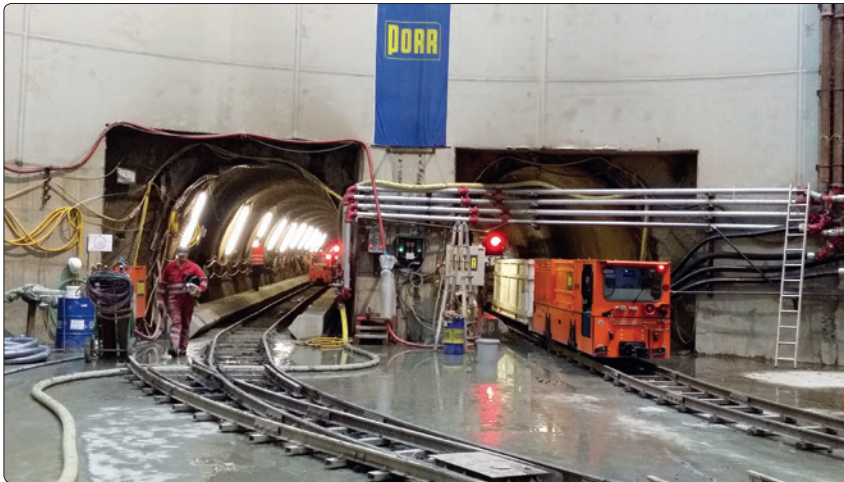
In Deutschland will die Porr heuer die Leistung von 802 Millionen Euro im letzten Jahr auf über eine Milliarde hochschrauben (im Bild: Emscher Abwasserkanal).
