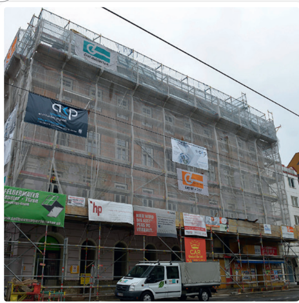
Bei der Sanierung in der Mariahilferstraße 182 kommt erstmals ein Aerogel-Hochleistungsdämmputz zum Einsatz.
