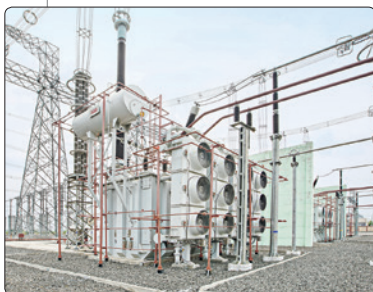
1.200-Kilovolt-Drehstromtransformator unterstützt Indiens Ultrahochspannungsnetz-Plan.
