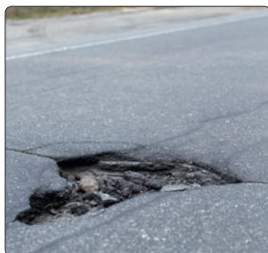
Wird fünf Jahre mit der Sanierung einer Straße gewartet, steigen die Kosten um 24 Prozent, bei neun Jahren sogar um 150 Prozent.
