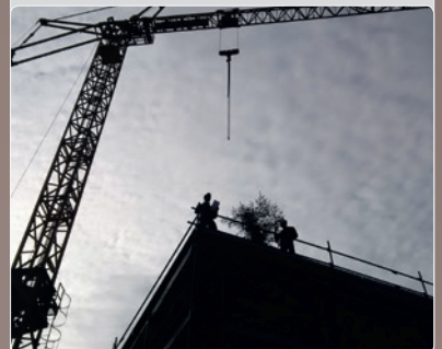
Firstfeier der Wohnanlage »Wallenmahd«, die auch als Forschungsobjekt für alternative Be- und Entlüftungskonzepte dient.
