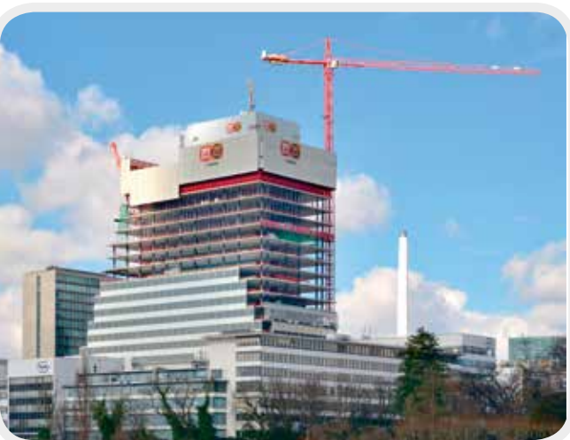
Das höchste Bauwerk der Schweiz klettert mit der Meva-Schalung Woche für Woche um eine Etage seinem Höhenrekord entgegen
