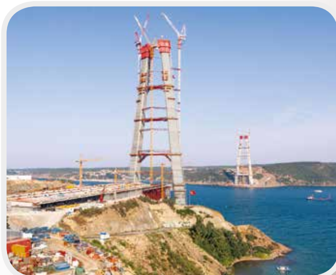
Die dritte Bosphorus-Brücke, die Brücke mit den höchsten Brückenpfeilern aus Beton weltweit, verbindet nach Fertigstellung im Jahr 2015 den europäischen mit dem asiatischen Kontinent.
