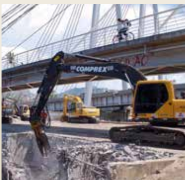
Mithilfe von Atlas Copco-Maschinen wurde eine aus 1.300 m 3 armiertem Beton bestehende alte Brücke entfernt.
